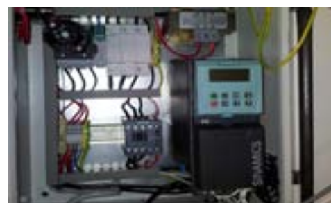
Quadro di controllo SIEMENS
